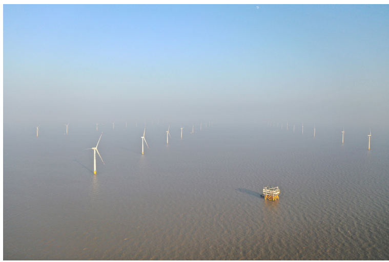
图为三峡能源江苏大丰H8-2海上风电场。
